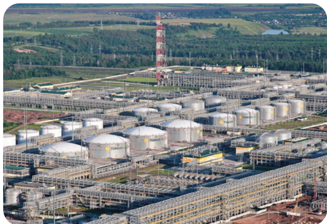
Резервуарный парк в Альметьевске. Комплексы пожарного оборудования. Заказчик: ТАНЕКО, ТАТНЕФТЬ
