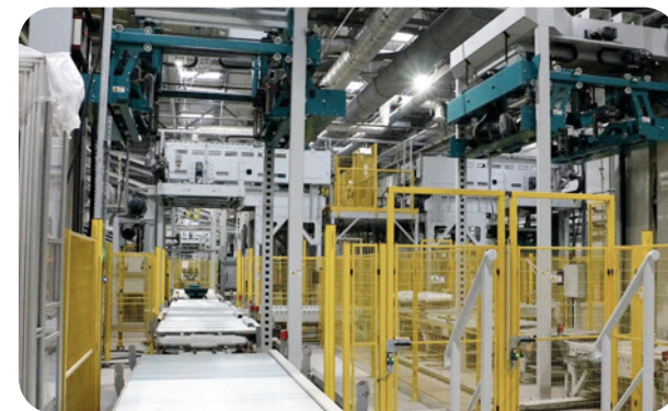
ЗапсибНефтехим (СИБУР). Логистическая платформа. Пожарное оборудование, генераторы пены, система хранения и дозирования пенообразователя, пенообразователь «Аквафом». Заказчик: Ямата Эндюстриел (филиал)
