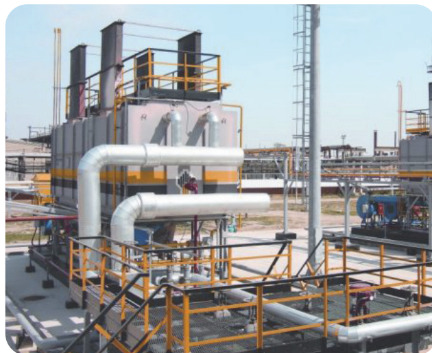
Ставропольнефтегаз. Станция пожаротушения, пожарное оборудование. Заказчик: РН - Ставропольнефтегаз
