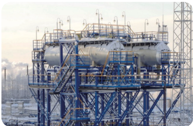
Утинский НПЗ. Блок-контейнер пенного пожаротушения, пожарное оборудование. Заказчик: ЛУКОЙЛ-Ухтанефтепереработка
