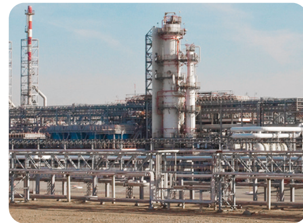
Лукойл-Волгограднефтепереработка. Блок-контейнер пенного пожаротушения, пожарное оборудование. Заказчик: ИЦ «Технохим»
