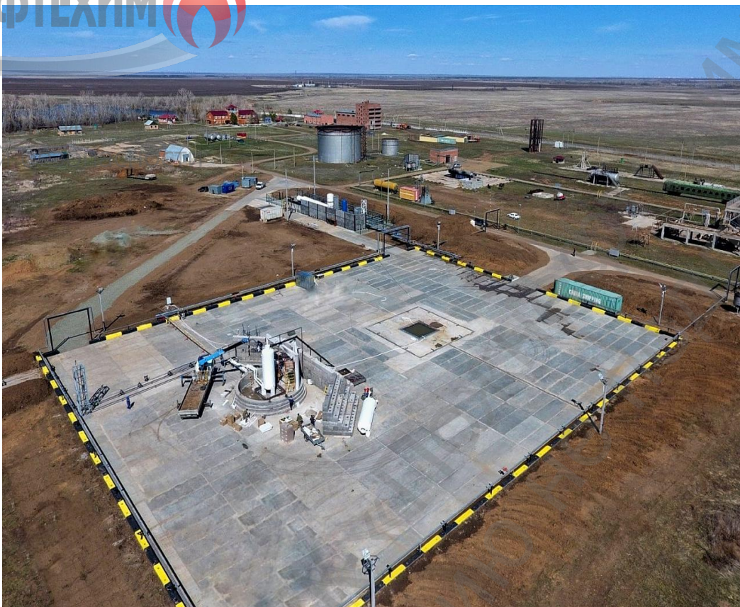
Рисунок 1 – Общий вид Полигонного стенда для проведения экспериментальных исследований потенциальной пожарной опасности аварийных ситуаций в технологических процессах с наличием СПГ
